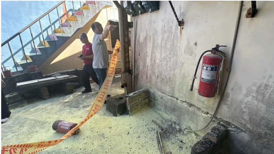
基隆市通仁街1支放置在戶外的滅火器，今天上午爆裂，市府表示會加快汰舊換新作業。圖／讀者提供
