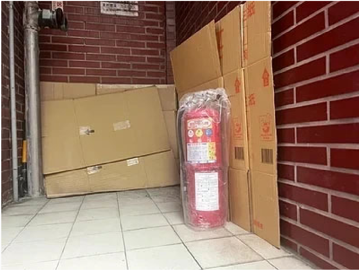
里鄰滅火器設置在室外，易因曝曬或雨淋，導致鋼瓶嚴重鏽蝕。記者王長鼎／攝影
