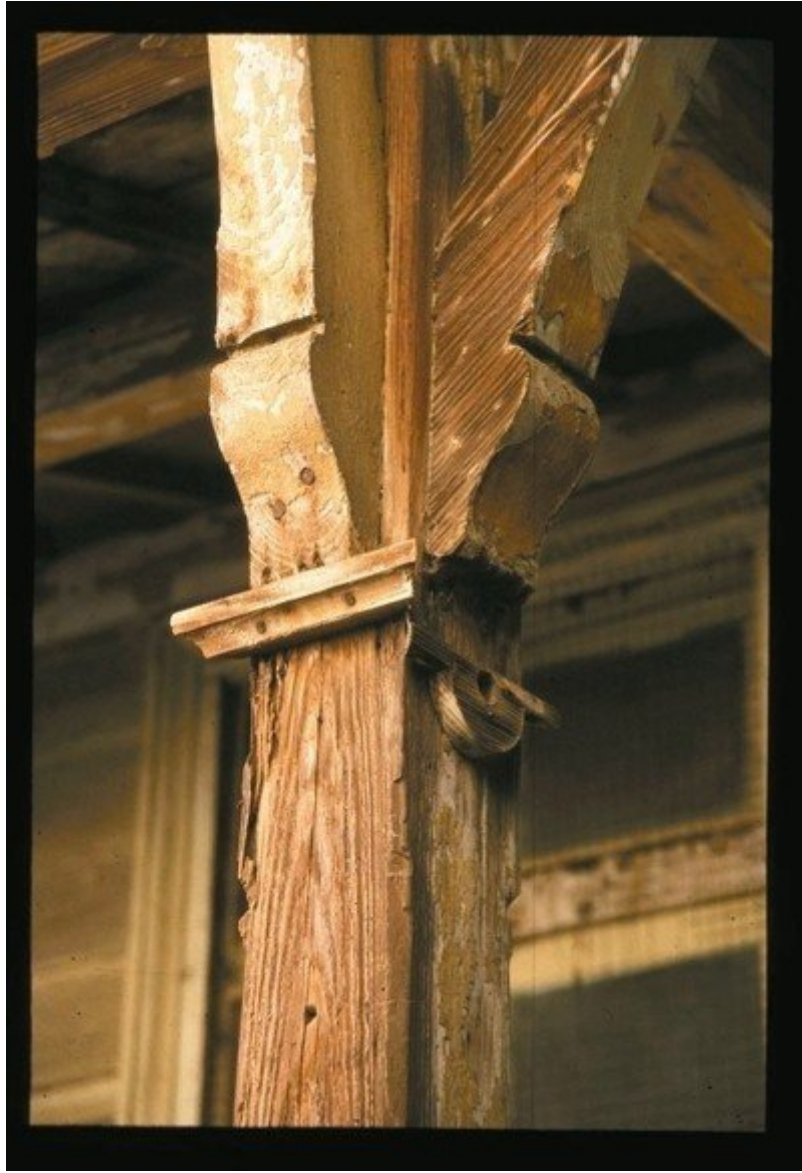
正面門廊弧形托架下方原本是有木製柱頭的殘跡，修復後卻不見了。 記者吳淑玲 / 翻攝
