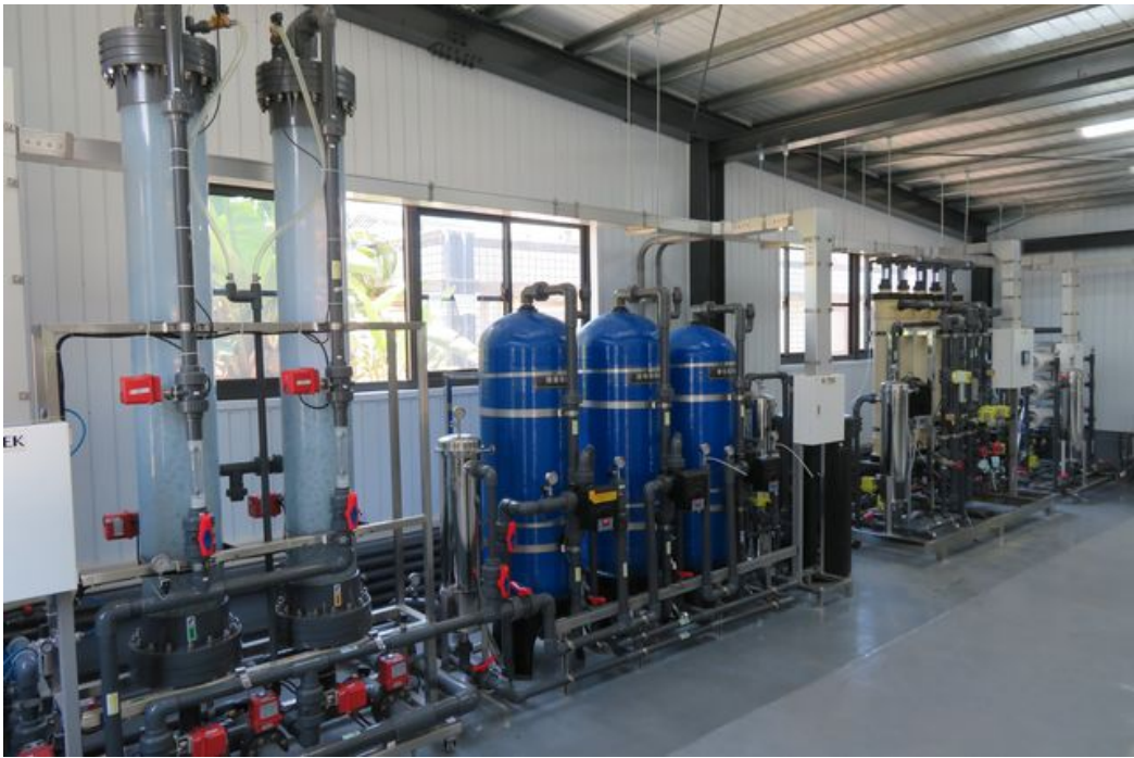
嘉藥擁有全國第一座設於校內的類產業再生水廠。
