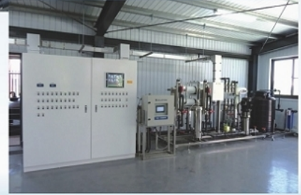
↑ 高級再生水工廠的單元設備(二)
