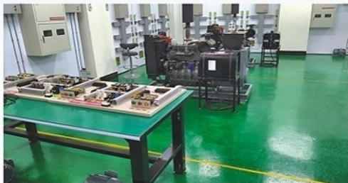
↑ 「下水道設施操作維護」機電設備
