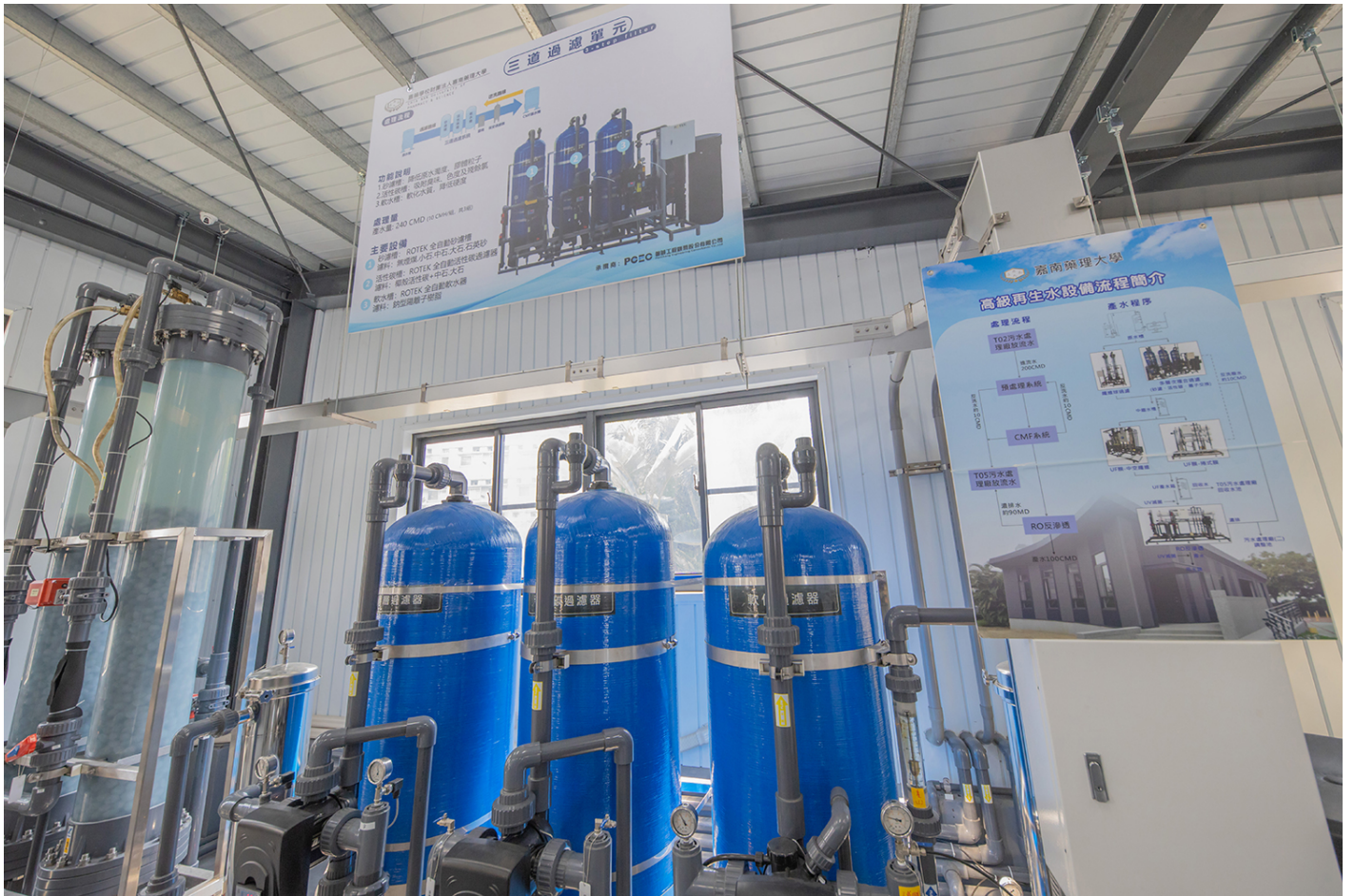
高級再生水的三道過濾系統。
